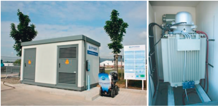
Abb. 3.8 Ortsnetzstation mit regelbarem Ortsnetztransformator (rechtes Bild) zur Kopplung der Mittelspannungsebene (10 kV, 20 kV) mit der Niederspannungsebene 0,4 kV. Quelle Maschinenfabrik Reinhausen GmbH
